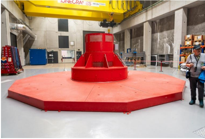
Turbine im Kraftwerk Innerkirchen*
